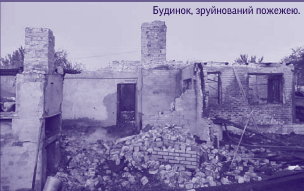
Будинок, зруйнований пожежею.
